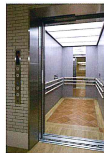
1 階 エレベーター
