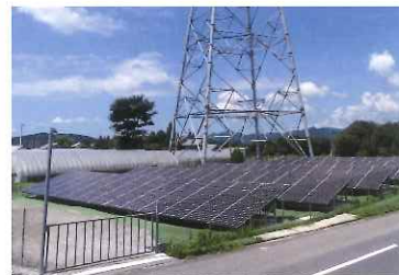
太陽光パネル
